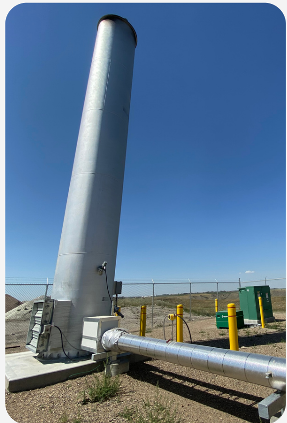
Landfill Gas Flare
